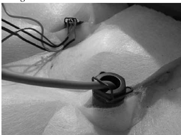
Rys. 16 – Widok czujnika temperatury wody TK podłączonego do kotła typu DxxP
